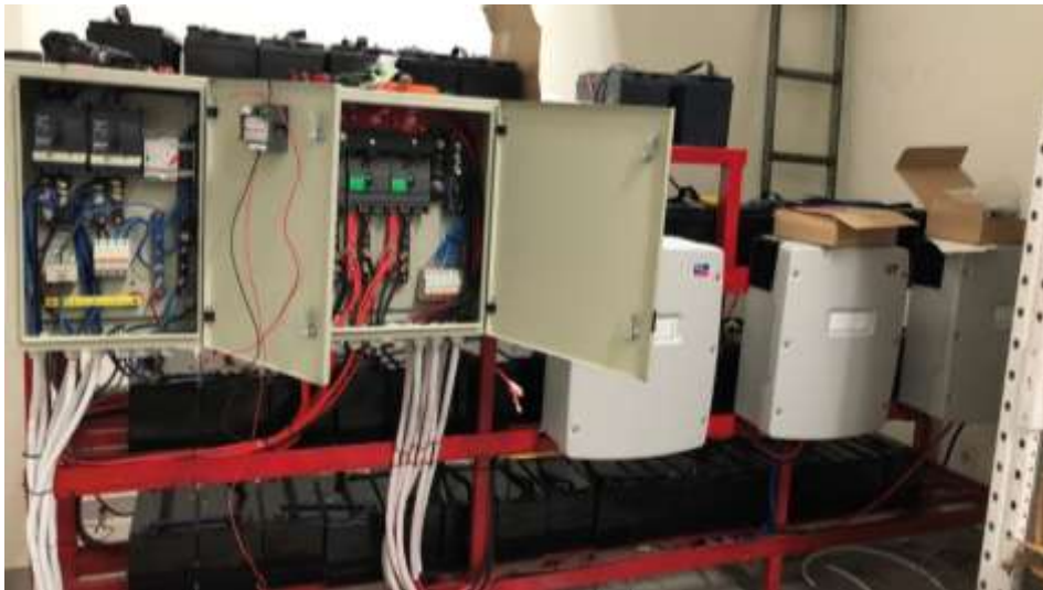
Implementasi Baterai Energy Storage System di smart grid Gedung CAS
