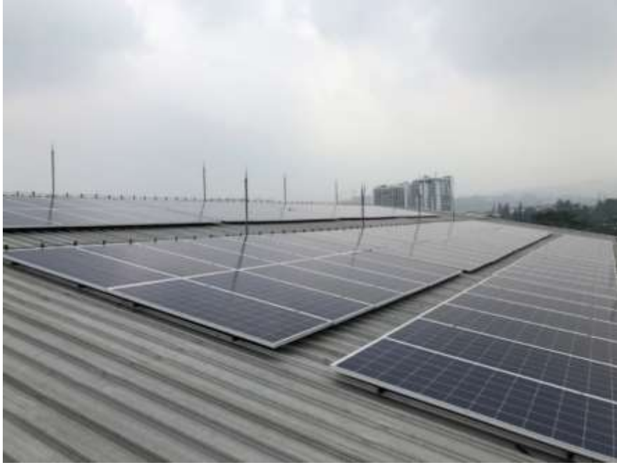
instalasi PLTS rooftop 40kW di Gedung CAS
